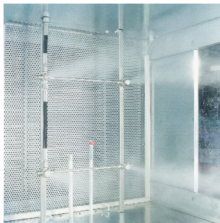
Bild 3 In RLT-Anlagen verhindert eine tropfenfreie Hochdruckverneblung Keimbildung und Korrosion im Kanal
